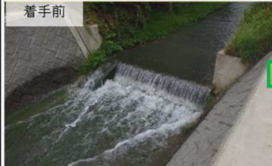
着手前 大きな落差があり、なまずの遡上の阻害となっている。
