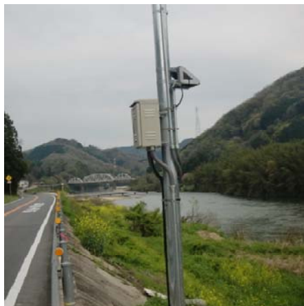
簡易水位計 (木津川)
