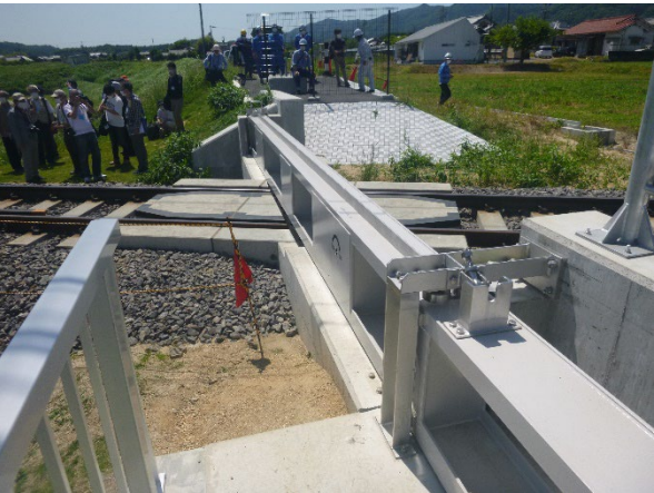
写真－1 陸閘を閉鎖した状態
