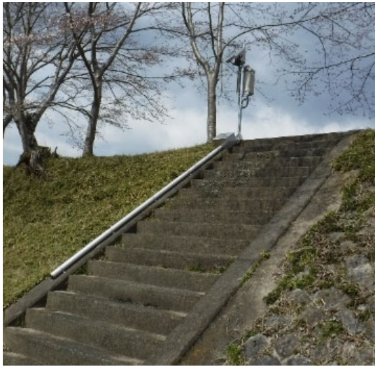
危機管理型水位計設置状況
