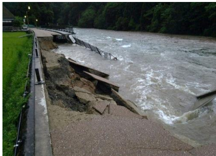
巡視で確認された河岸侵食
