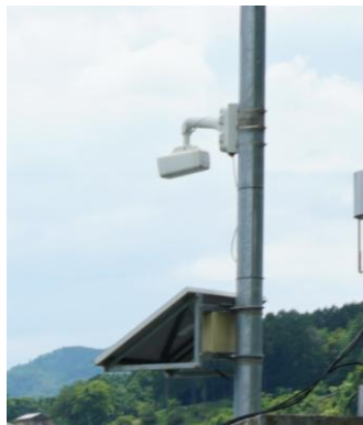
簡易型河川監視カメラ
