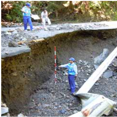
被災状況調査
