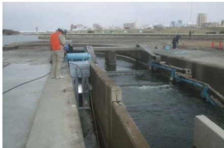
小水力発電設備 提供：近畿地方整備局
