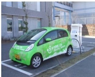
こうべ環境未来館に設置した急速充電器 提供：神戸市
