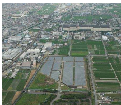
京都市水垂埋立処分地における大規模太陽光発電所 (提供：京都市)
