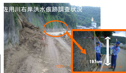
佐用町豪雨被害時の TEC-FORCE 隊員による現地調査
