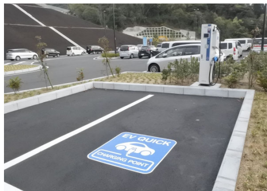
道の駅「みさき」のEV充電施設
