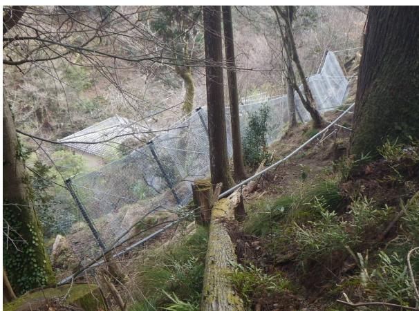
落石防護柵工（斜面对策）
