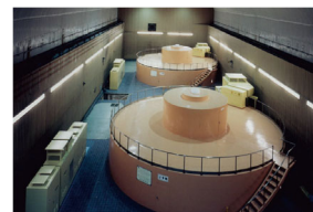
地下の水力発電施設
