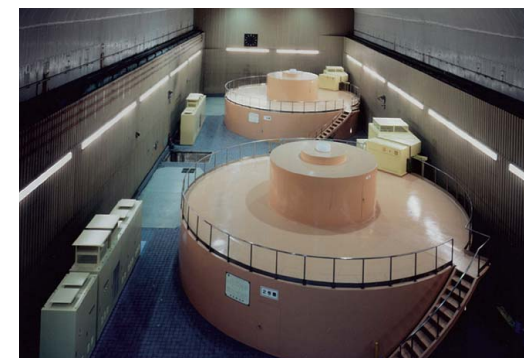
地下の水力発電施設
