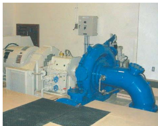
真名川ダム管理用水力発電設備
