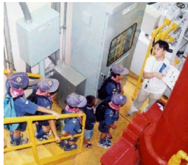
■主放水設備等説明
