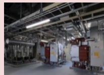
空調用熱源機器
