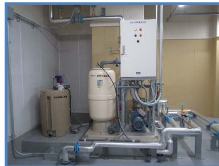
雨水再利用設備
