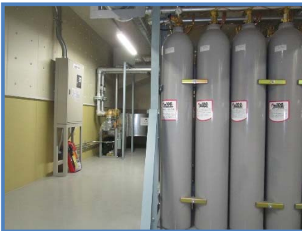
不活性ガス消火設備
