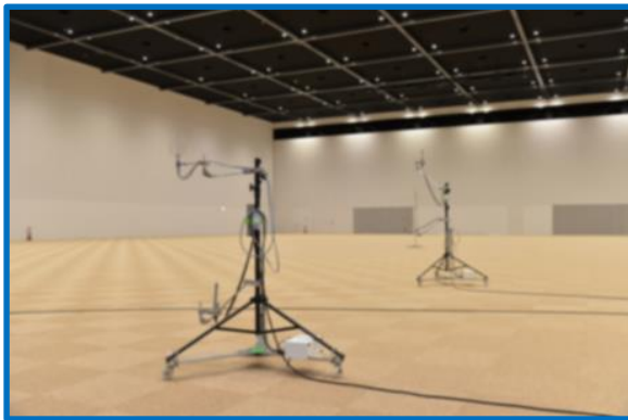
3D気流分析機器設置状況写真
