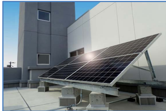
太陽光発電設備
