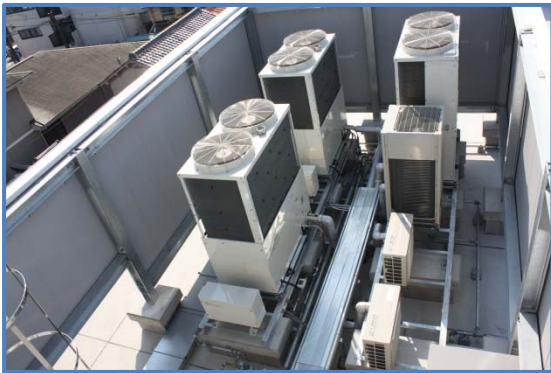
GHP室外機（保護バッテリー付）
