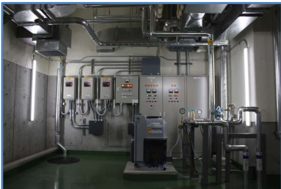
雨水再利用設備（ろ過装置）
