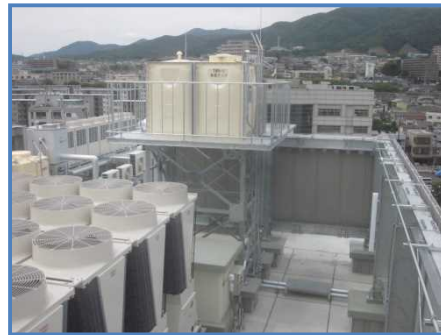
屋上高架水槽
