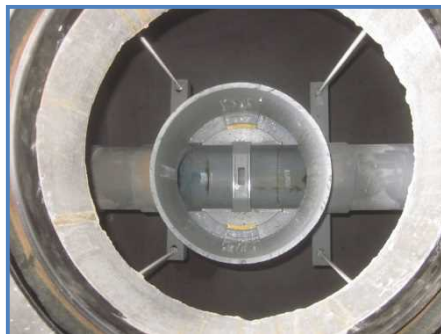
屋外非常用切替樹
