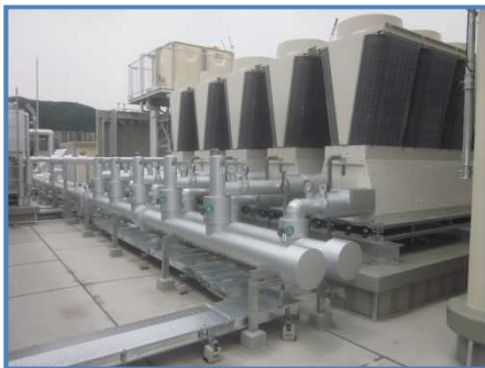
屋上空冷チラー
