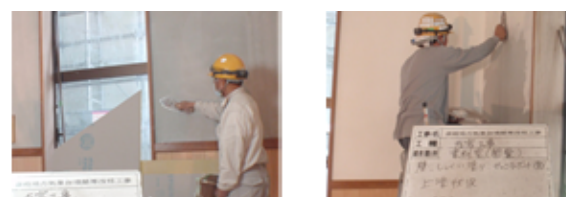
漆喰施工状況 (下地調整、材料練り混ぜ、仕上げ) 写真-5 漆喰仕上げ
