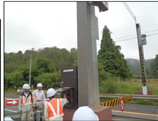
通常時 自動操作訓練
