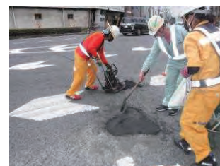
応急的な補修
