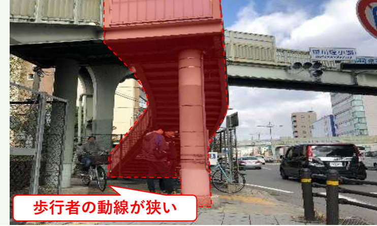
【写真③】階段が通行の支障
