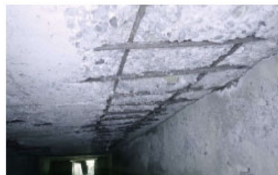
<頂版の鉄筋露出>
