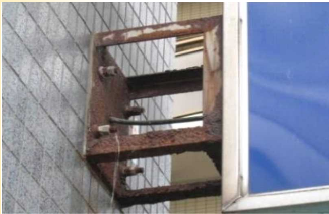
ブラケットの腐食による落下の危険のある看板 (国土交通省HPより)
