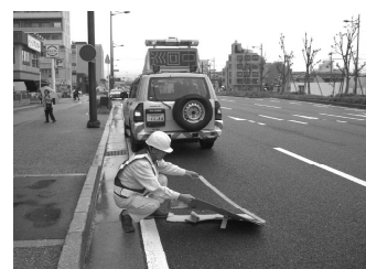
落下物の処理
