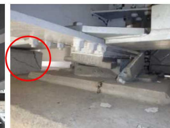
写真-6 支承の破損の状況
