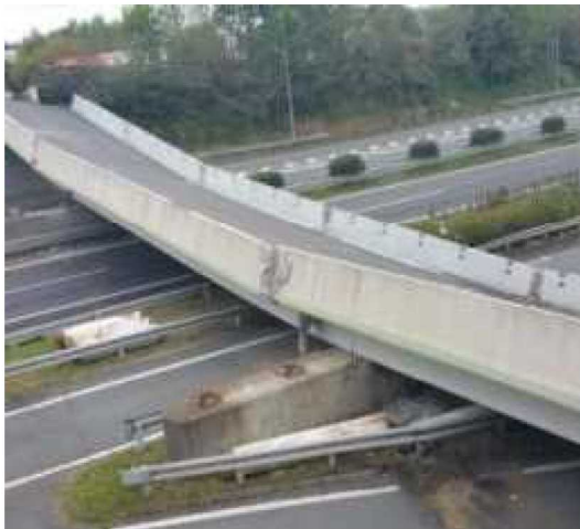
九州自動車道をまたぐロッキング橋脚の落橋 (県道小川嘉島線・府領第一橋)
