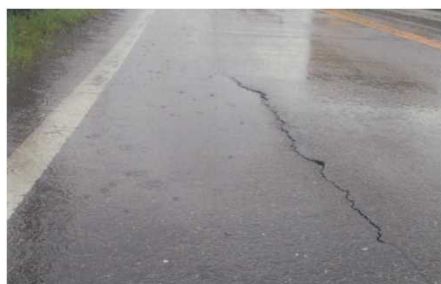
ひび割れの入った舗装
