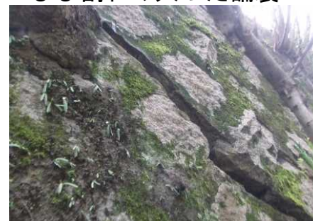
ひび割れの入った石積
