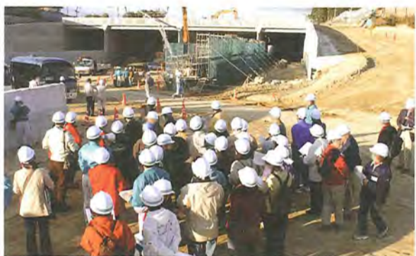
⑥ 長尾東地区・開削工事の現場。そのスケールの大きさにビックリ
