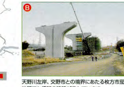
天野川左岸、交野市との境界にあたる枚方市茄子作地区でも橋脚の建設が進んでいます
