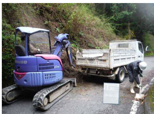
▲国道480号の法面崩壊状況(復旧作業中)(H27.4.21)
