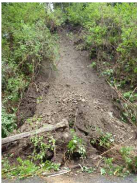
▲国道480号の法面崩壊状況(H27.4.21)
