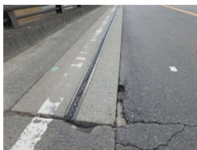
縦目地部(舗装)の損傷
