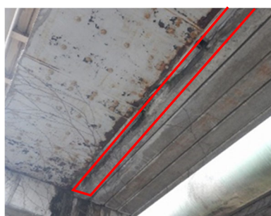
縦目地部の遊離石灰(漏水)
