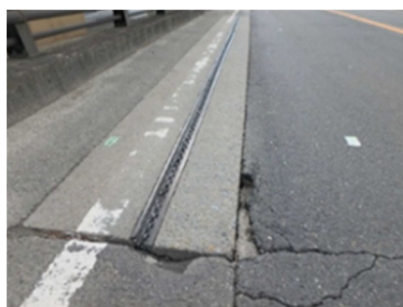
縦目地部(舗装)の損傷
