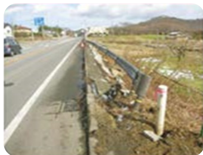
ガードレール・ 標識等の損傷
