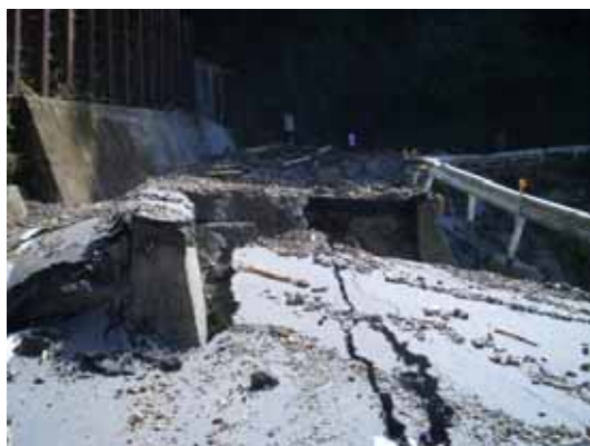
土砂崩落による通行止め (十津川村平成23年9月15日撮影)
