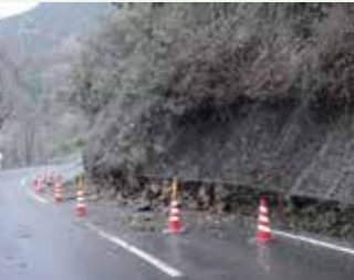
国道168号の風屋地区での土砂崩落状況(平成24年4月)
