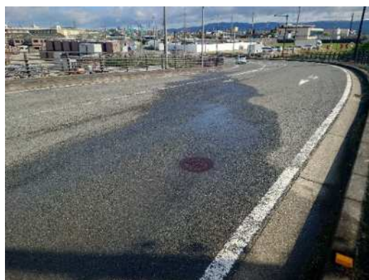
補修前漏水状況
