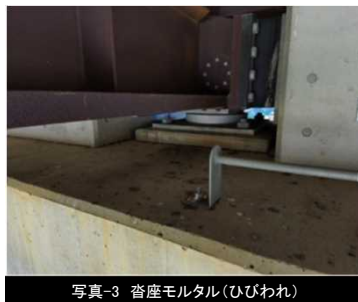
写真-3 沓座モルタル(ひびわれ)
