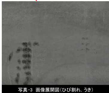
写真-3 画像展開図(ひび割れ, うき)
