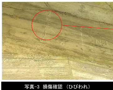
写真-3 損傷確認 (ひびわれ)
