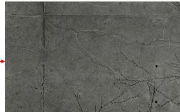
写真-2 画像展開図(ひび割れ)
