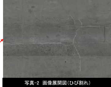
写真-2 画像展開図(ひび割れ)
