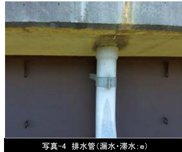
写真-4 排水管(漏水・滞水:e)
