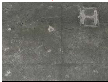
写真-3 画像展開図(ひび割れ)
