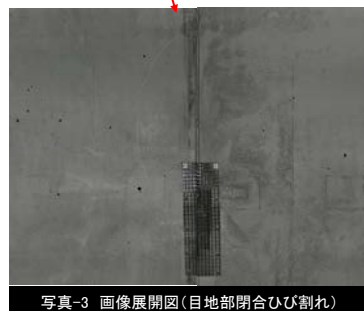
写真-3 画像展開図(目地部閉合ひび割れ)
