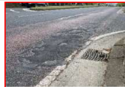
【損傷度Ⅲ：修繕段階】 損傷が著しい段階
