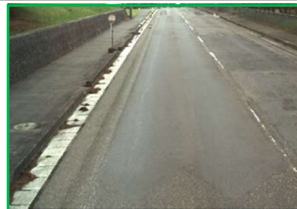
【損傷度Ⅱ：表層保持段階】 損傷がある程度進んだ段階
