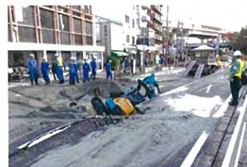
埋設管の老朽化に伴う道路陥没
