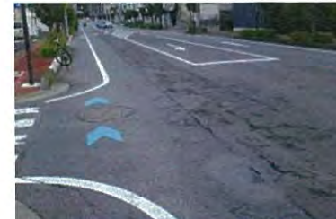
占用工事が起因する路面損傷
