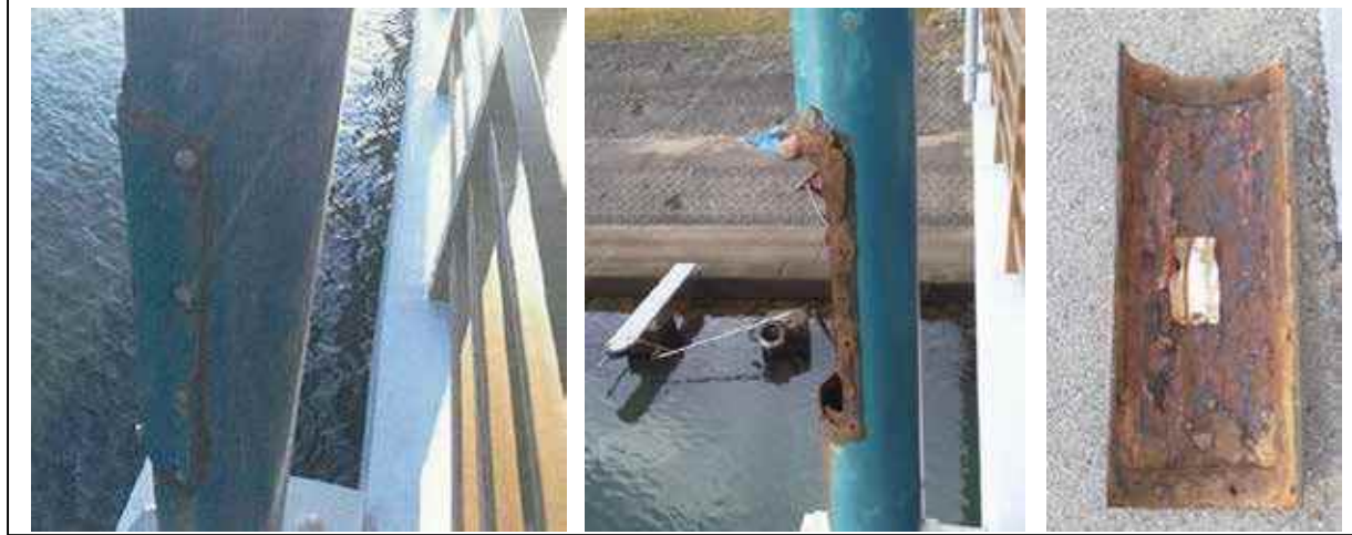
転倒した照明柱と同タイプの状況
