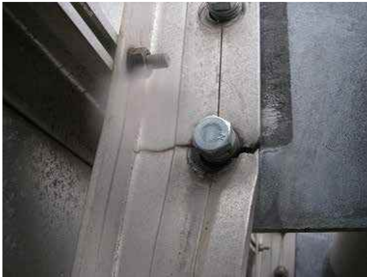
き裂損傷 (車両衝突)
