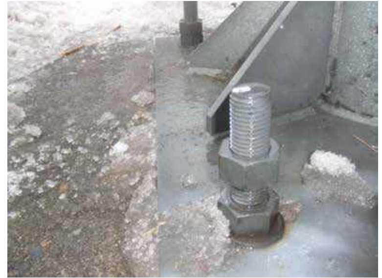
ボルトの緩み (施工不良)
