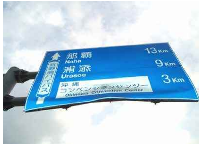
異常変形 (車両衝突)
