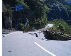
写真B: 道路崩壊による通行止め (平成23年9月4日撮影)
