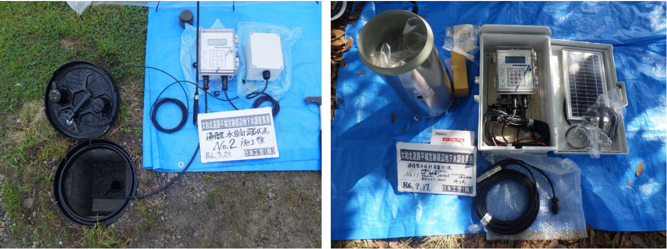
写真—1 設置機材一式（左：マンホールタイプ 右：平城宮内地上立上げタイプ）
