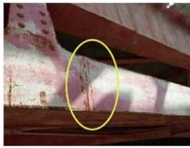
【鋼材溶接部の亀裂の懸念】
