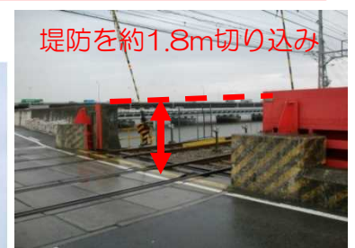
▲ 堤防欠損部分
