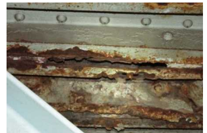
トラスの腐食
