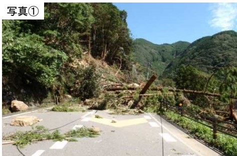
紀伊半島大水害時の大規模な法面崩壊 (H23.9 新宮市高田)
