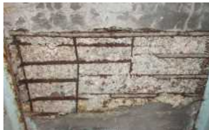
床版の剥離・鉄筋露出
