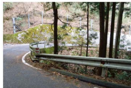
写真② 線形不良箇所(曲線半径 R < 15m )
