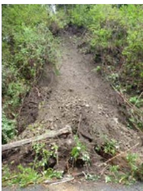
▲国道480号の法面崩壊状況(H27.4.21)
