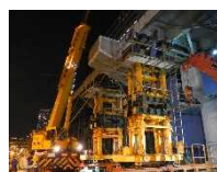
軌条設備上に自走式油圧ジャッキ架台を組み立て、切断したRC橋脚梁ブロックを空頭制限を受けない桁外側まで引き出している状況
