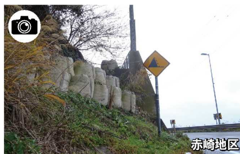
防災点検要対策箇所の状況
