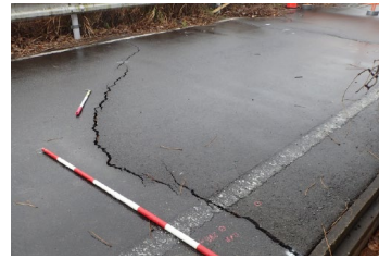
市道路面クラック
