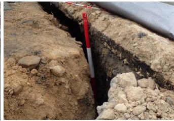
法肩部クラック
