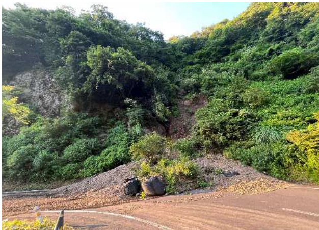
写真3 法面崩落状況(R6.4.26規制解除)
