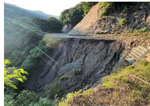
写真4 道路損壊状況(R6.4.26規制解除)
