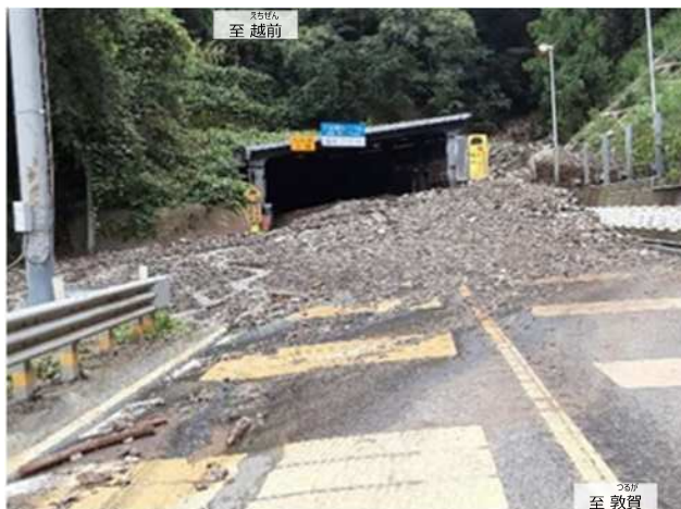
写真1 土砂流入状況(R4.8.10規制解除)
