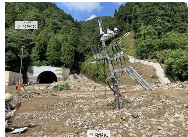
写真2 土砂流入状況(R4.8.26規制解除)
